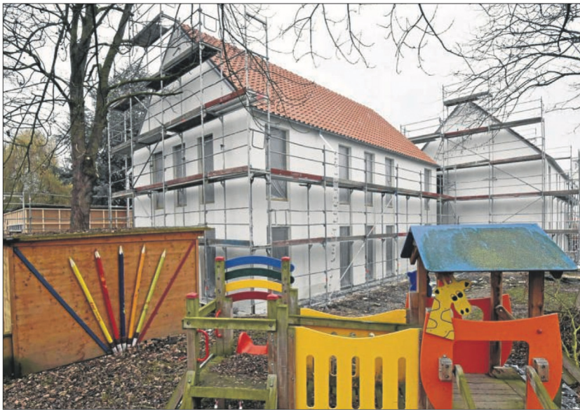
Die Arbeiten am neuen Patrokli-Kindergarten in der Schonekindstraße sind weit vorangeschritten. • Foto: Dahm
