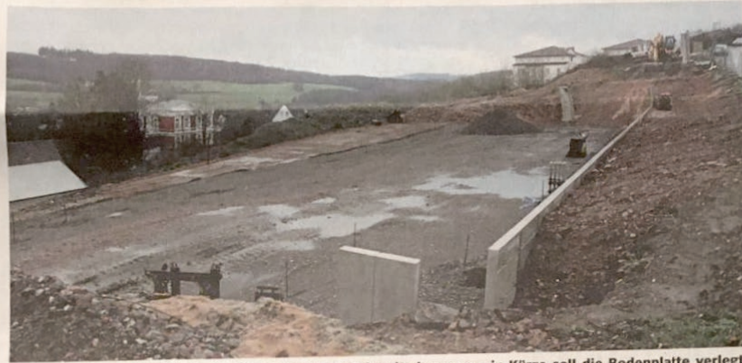
Die Bauarbeiten an der Straße Am Timmerbeul haben bereits begonnen, in Kürze soll die Bodenplatte verlegt werden. Die neue DRK-Kita wird zweigeschossig in den Hang hineingebaut. FOTO: HARTMUT BREYER
