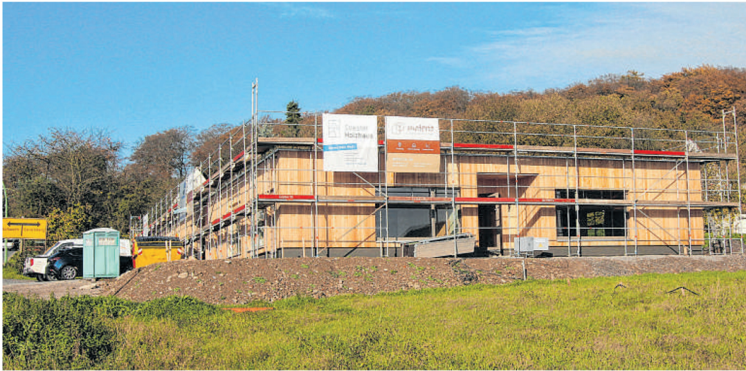
Der Rohbau des AWO-Kindergartens an der Hembecker Talstraße am Büthenberg steht. Nun beginnen die Installationsarbeiten.
